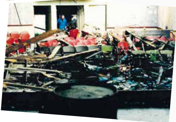
20, 22 et 23 mai 1995 : Démolition de la toiture de la salle Saint Aubin par les membres de l'association des chapelles.
