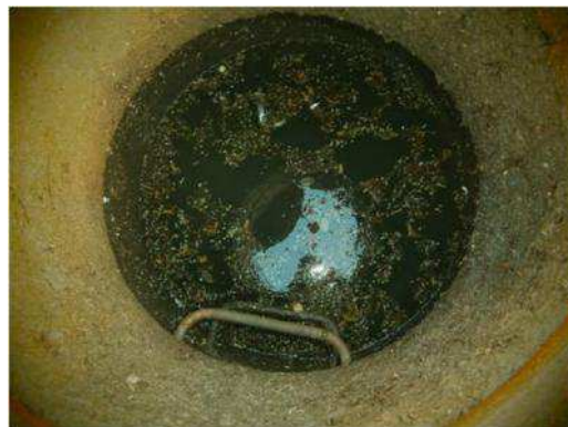
Photo 10 et 11 : Réseau en charge avenue du Général De Gaulle par temps de pluie et temps sec
