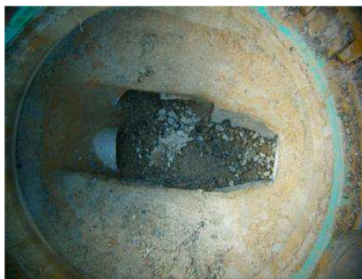
Photo 5 : Réseau de l'EHPAD à curer
